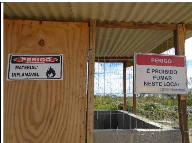
Figura 12.6.1-9 – Baia de armazenamento de produtos químicos (outra obra).
