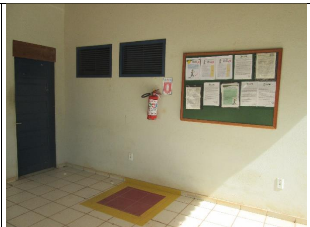
Figura 12.6.1-10 – Sinalização e armazenamento de extintores de incêndio em local de fácil acesso (outra obra).
