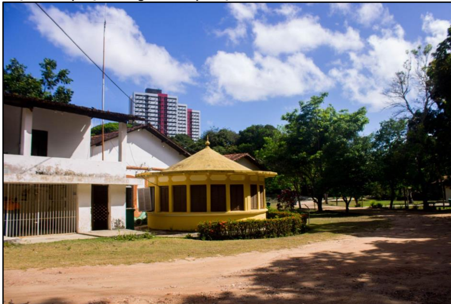
Figura 3.8. Poço de captação d'água em operação situado no setor central do Jardim Botânico
