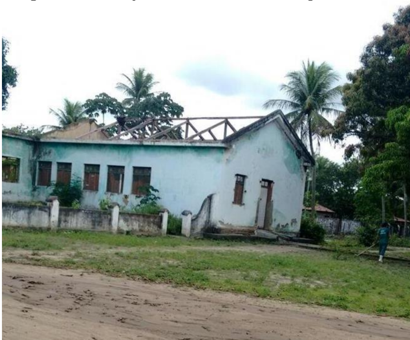
Figura 65- Instalações da Colônia Getúlio Vargas em ruínas.
